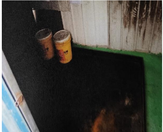
危废贮存库内部防渗、托盘等
