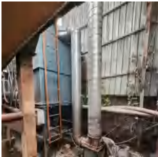
布袋除尘器及15m排气筒
