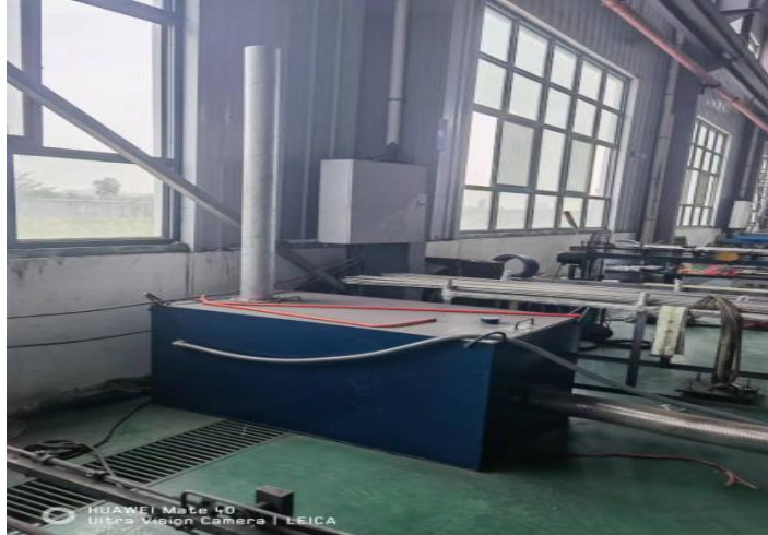
图4-1 迁建前项目采用的侧吸风+水箱除尘照片
