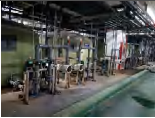
污水处理设施 1
