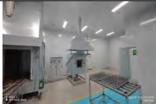
烧结炉区域集气设施
