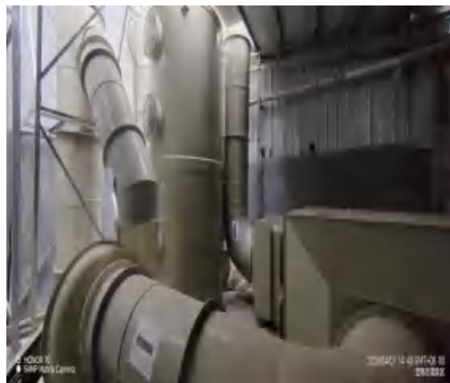
碱液吸收塔+除湿器+二级活性炭
