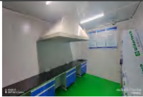
涂覆配料区集气设施
