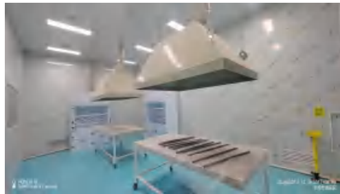
涂覆区域集气设施
